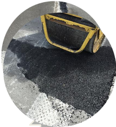
Betonautobahn AKR Schäden
